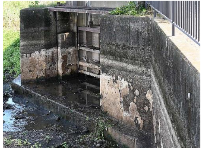
コンクリート護岸に付着したタンスイカイメン
